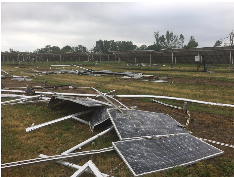
Také solární panely, které loni zničilo tornádo na jižní Moravě, byly předány k recyklaci.
